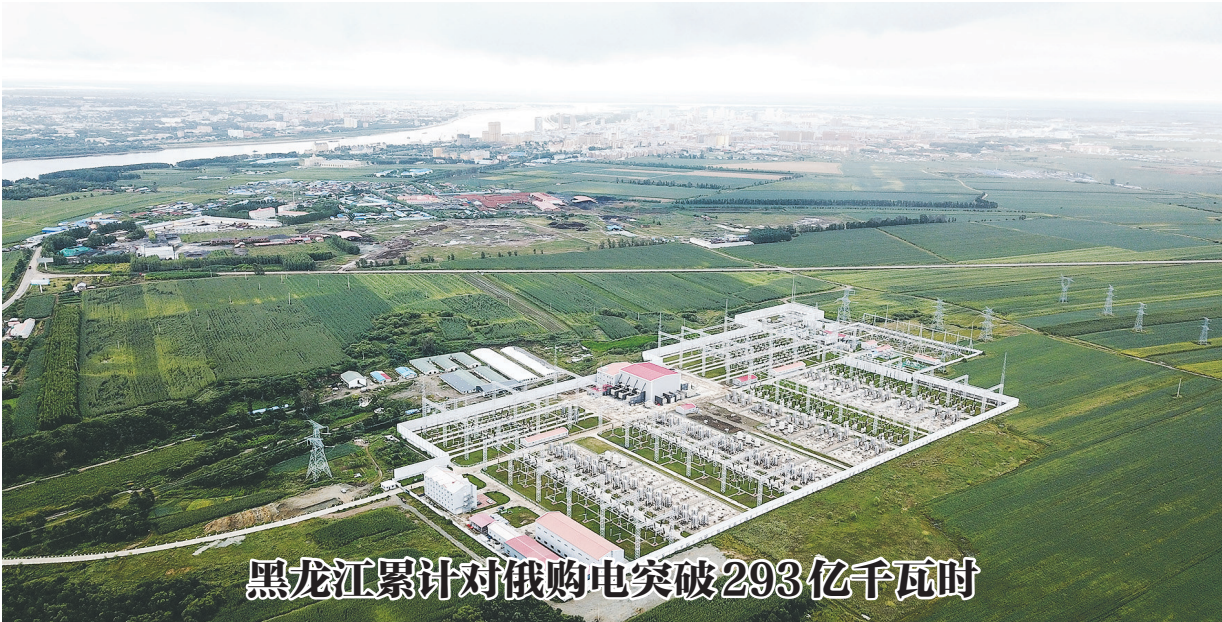
黑龙江累计对俄购电突破293亿千瓦时 国网黑龙江省电力有限公司数据显示,截至8月18日,黑龙江省今年完成对俄购电18.8亿千瓦时,27年来累计对俄购电293.16亿千瓦时,减少境内煤耗约991.7万吨,为中国东北部提供了充足稳定的清洁电能,也提高了俄罗斯远东地区富余能源的利用率。图为中俄直联网500千伏黑河背靠背换流站开关场。
