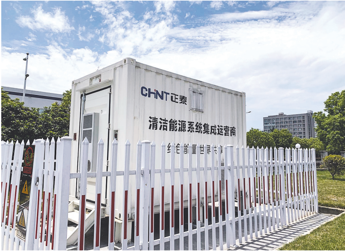
正泰新能源上海松江产业园1MWh储能项目 (正泰新能源供图)
