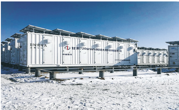
甘肃180MW/720MWh大规模储能电站 (科华恒盛股份有限公司供图)
