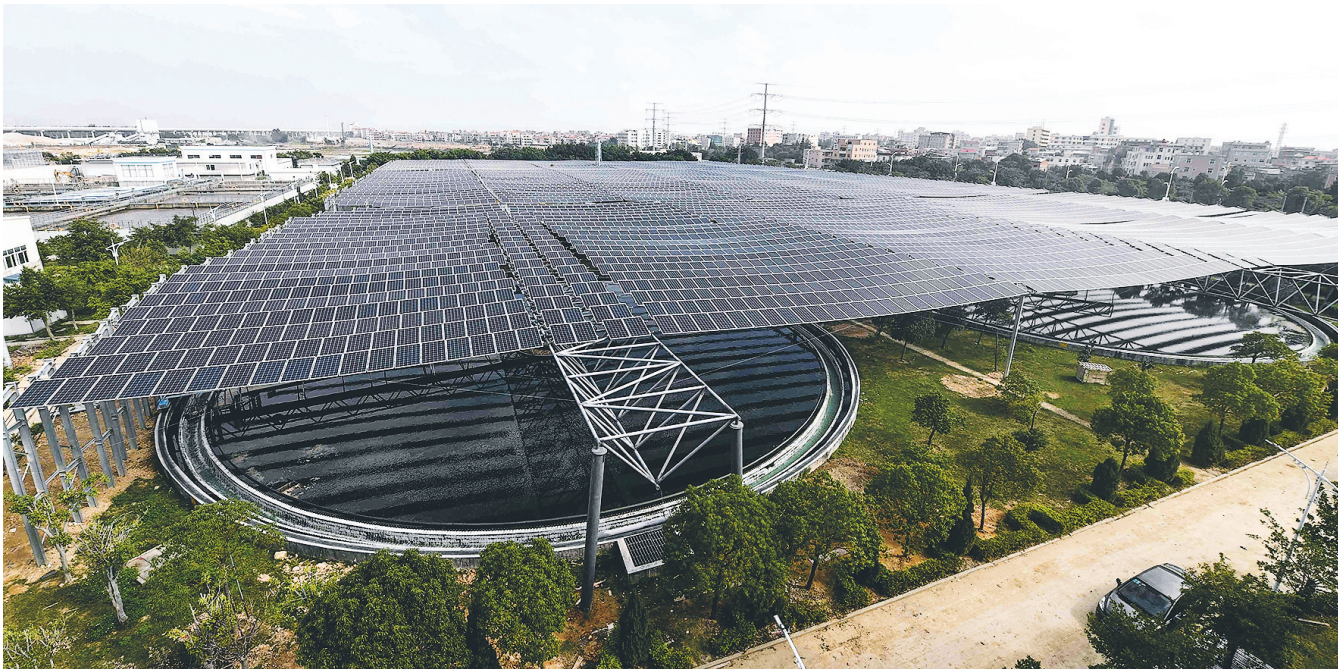
福建省石狮市中心区城市污水处理厂处理池上的分布式光伏发电项目
