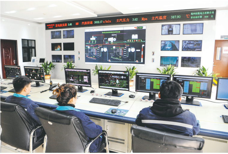
亳州洁能电力有限公司垃圾发电项目
