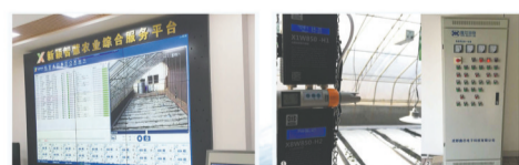
陕西大荔农业园区物联网建设项目
