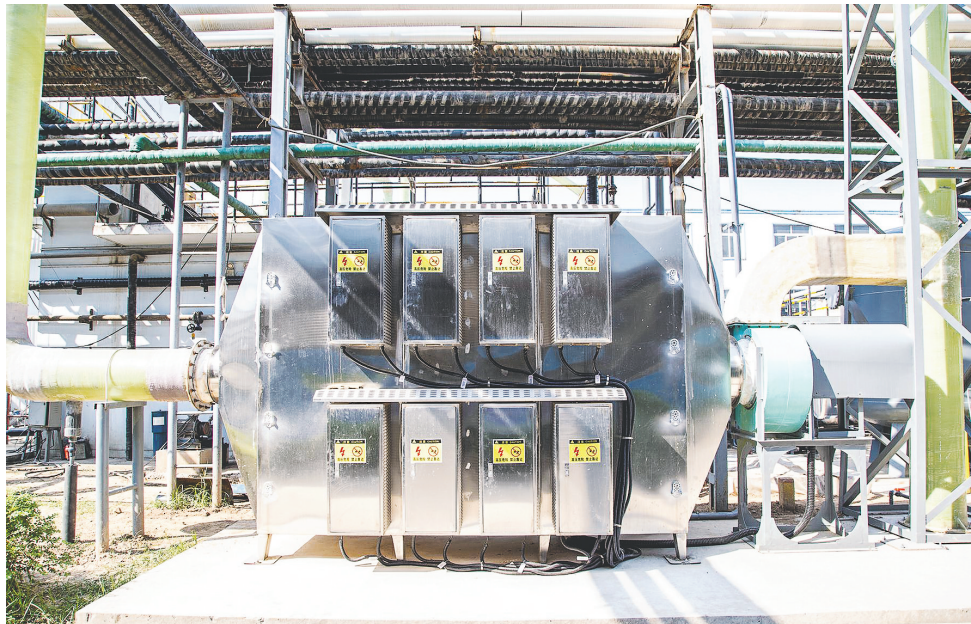
设备应用现场
