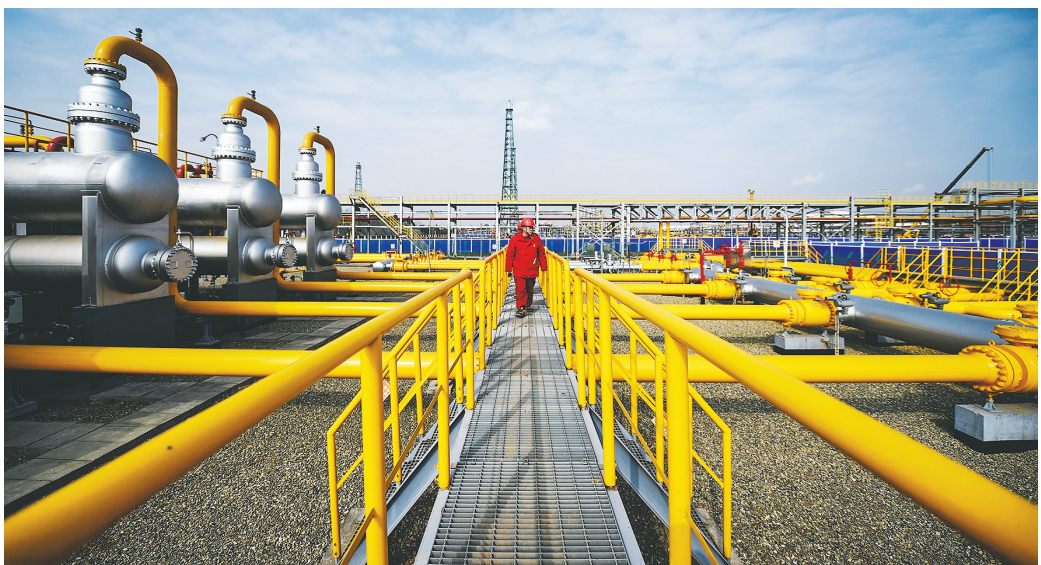
龙王庙组气藏加强生产运行管理，打造“电子巡井+定期巡检+周期维护+检维修作业”的气田管理新模式。
