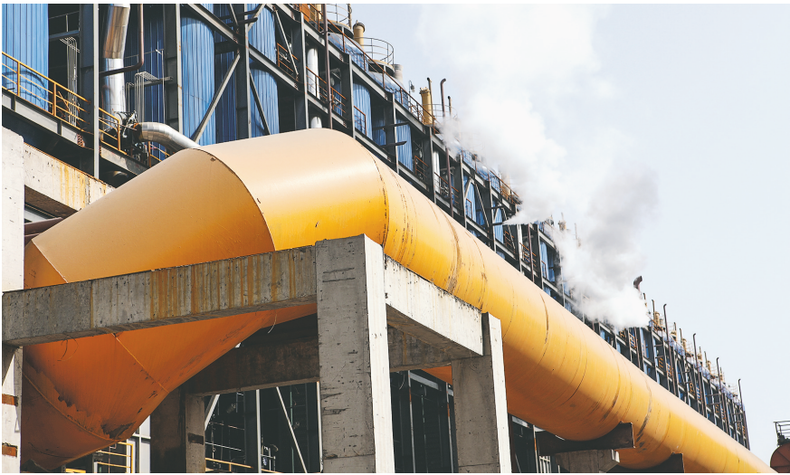
公司建造的交口肥美化工公司 10 × 2.0km³h 循环流化床煤气炉示范工程(冷凝器及主炉体)
