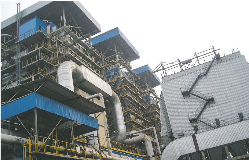
公司建造的荏阳煤矸石电厂 2 × 260TH 发电锅炉采用二(锅)炉三(发电)机
