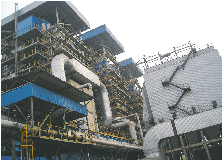
公司建造的荥阳煤矸石电厂 2×260TH 发电锅炉采用二(锅)炉三(发电)机
