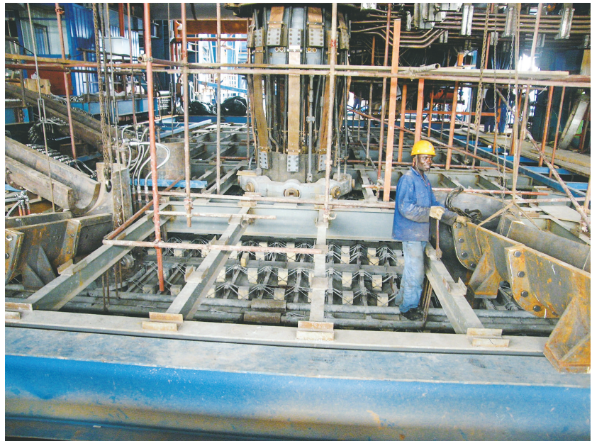
中色赞比亚 6300kva 沉积电炉示范工程
