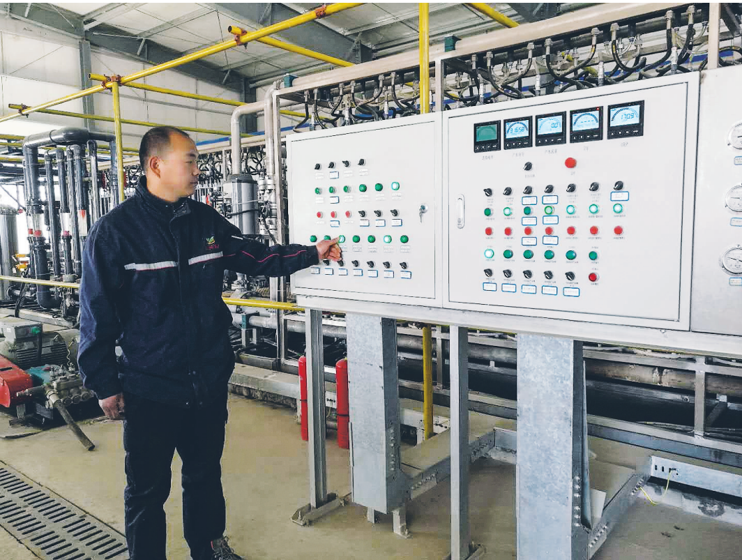
工人介绍污染治理装置
