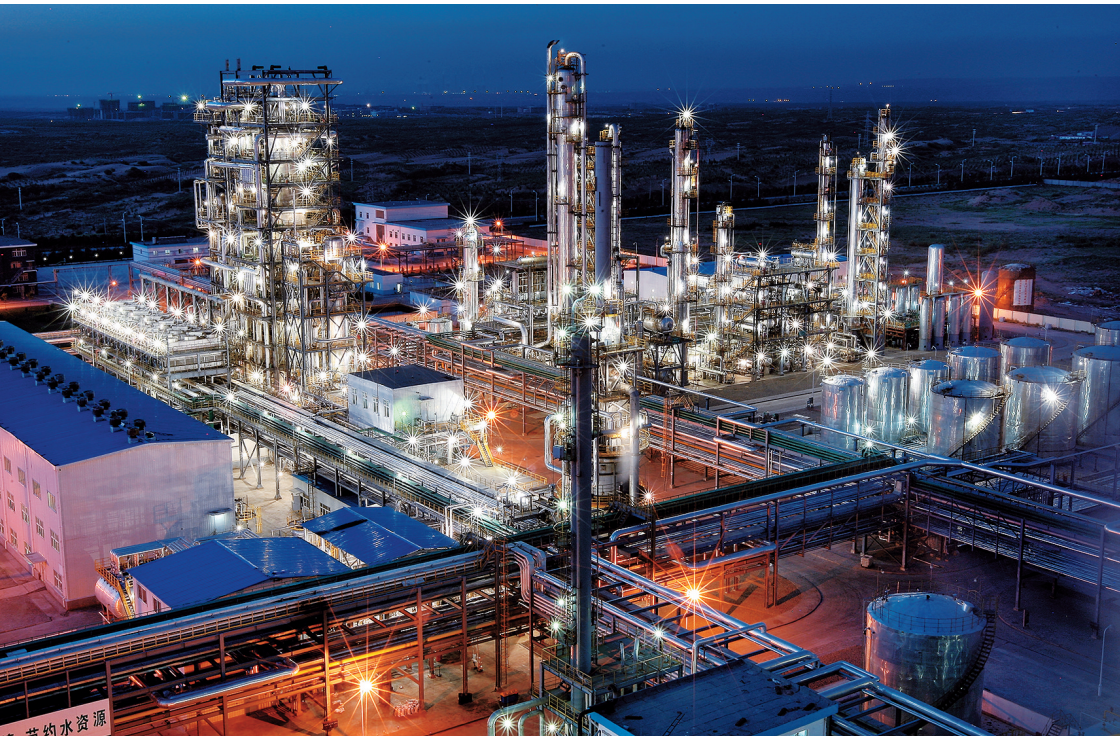
伊泰煤制油有限责任公司年产能16万吨煤制油项目
