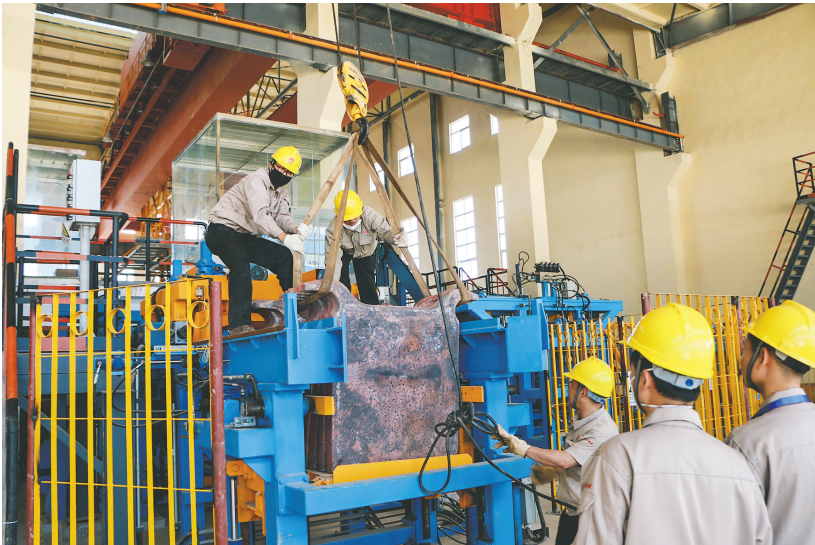
金铜项目电解阳极整形机组带负荷试车
